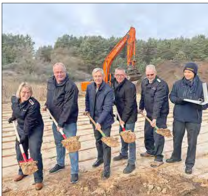
Beim ersten Spatenstich: Jugendwartin Julia Berdermann, stellvertretende Landrat Thomas Müller, Bürgermeister Henry Tesch, Geschäftsführer Baukonzept Neubrandenburg Thorsten Haker, Wehrleiter Wilfried Staff und Amtswehrführerin Anke Krüger (von links).
